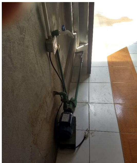
Figura 1. Canilla de Pasillo próxima al ingreso a la vivienda Manzana 24 Casa 98
